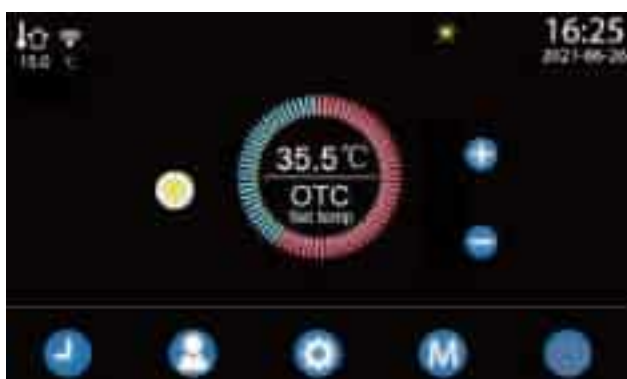
Interface no modo de aquecimento AC a funcionar no modo OTC
